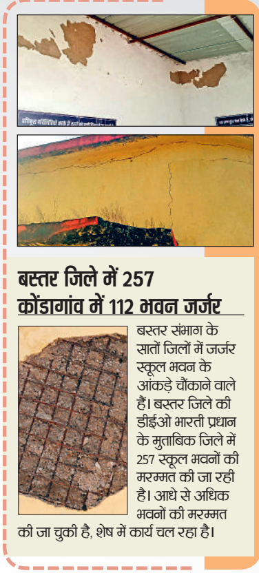
बस्तर जिले में 257 कोडागांव में 112 भवन जर्जर
